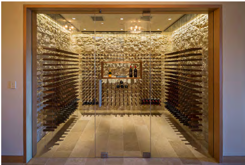
Foto: cantina climatizzata.
